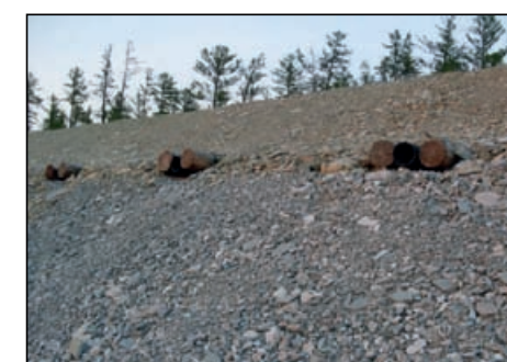
Поперечные охлаждающие трубы
