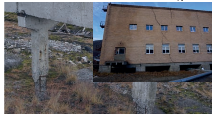
Разрушение зданий в пос. Пирамида
