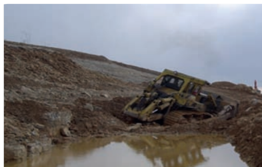
Гидролакколиты в земляном полотне
