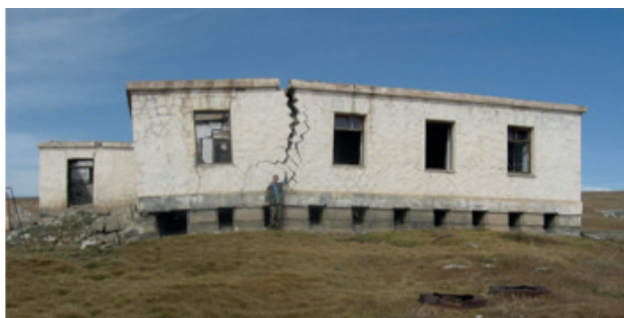
Разрушенное здание метеостанции "Тянь-Шань" в результате вытаивания подземного льда (3614 м над ур. м.), Кумтор, внутренний Тянь-Шань
